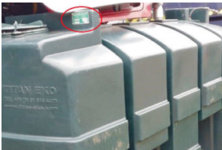
På pladen kan du se alderen på olietanken.
